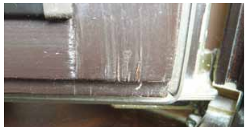
W wyniku zjawiska spęcznienia drewna ramiaków, następuje zrywanie się spoin klejowych na połączeniach czopowych, szczególnie narożnikowych i następuje zniszczenie połączeń konstrukcyjnych Fot. Z. Gęsiński
